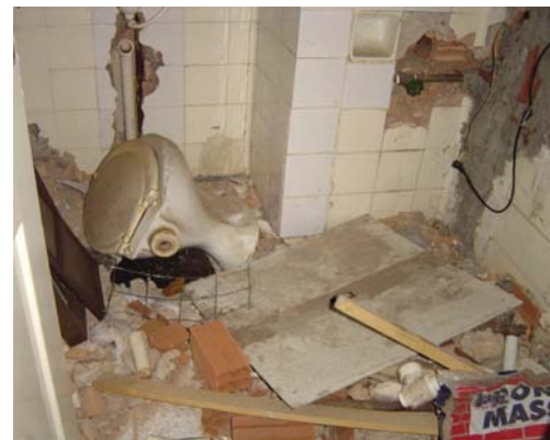
Foto de um dos banheiros do CRE Vitória: abandono atinge todo o prédio
